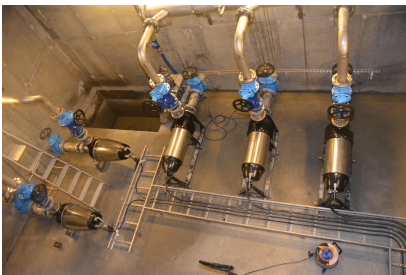
Pumpestasjon i Tunnel. Foto Tore Paulsen
