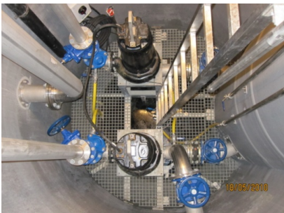
Pumpestasjon i kum. Foto: Terje Rønneberg
