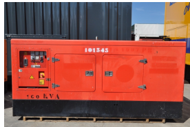
Stasjonært strømaggregat. Foto: Bredenoord
