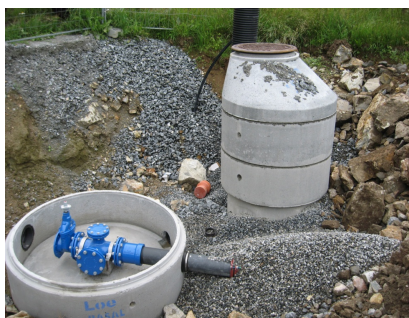
Vannkummer. Foto Terje Rønneberg
