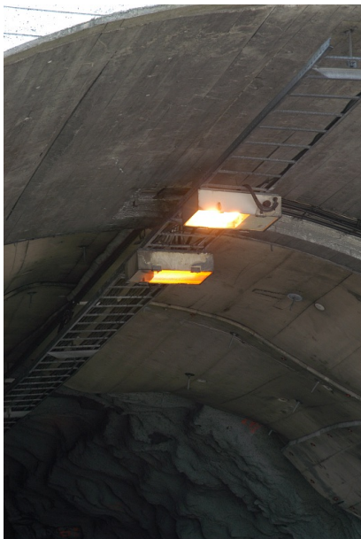
Lysarmaturer i Tunnel. Foto Kjell Wold
