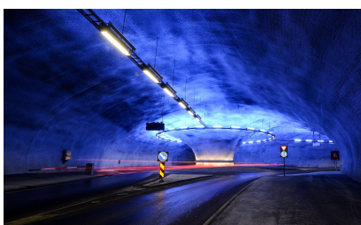
Lyssetting i Vallaviktunnelen. Foto Knut Opeide
