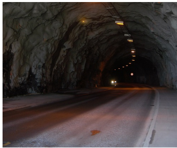
Figur 6: Kabelstige i tunneltak i Flekkerøytunnelen. Foto Kjell Wold
