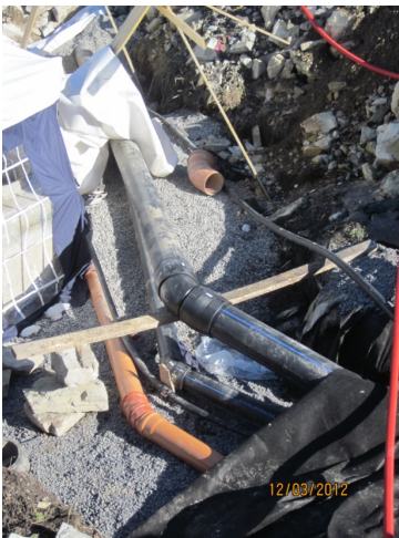
Figur 6: Rørledninger med bend. Foto Terje Rønneberg
