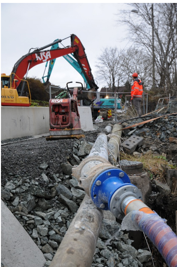
Figur 4: Rørledninger tilhørende veganlegg. Foto: Anja Kristin Bakken
