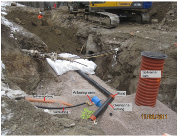
Figur 5: Rørledninger. Foto Terje Rønneberg
