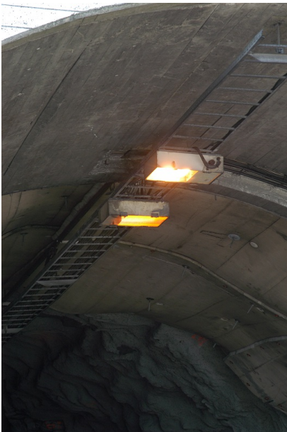
Lysarmaturer i Tunnel. Foto Kjell Wold
