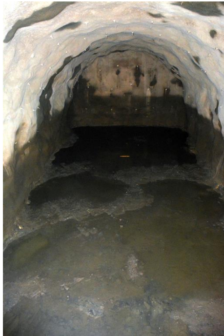
Pumpesump: Foto: Tore Paulsen
