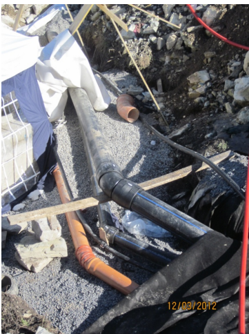
Figur 6: Rørledninger med bend. Foto Terje Rønneberg
