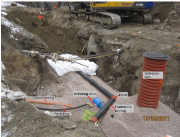
Figur 5: Rørledninger. Foto Terje Rønneberg
