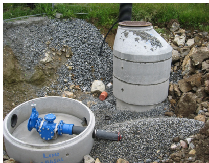
Vannkummer. Foto Terje Rønneberg
