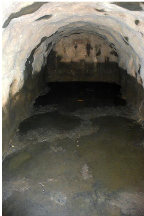
Pumpesump: Foto: Tore Paulsen
