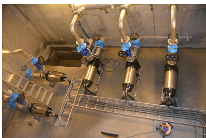
Pumpestasjon i Tunnel. Foto Tore Paulsen
