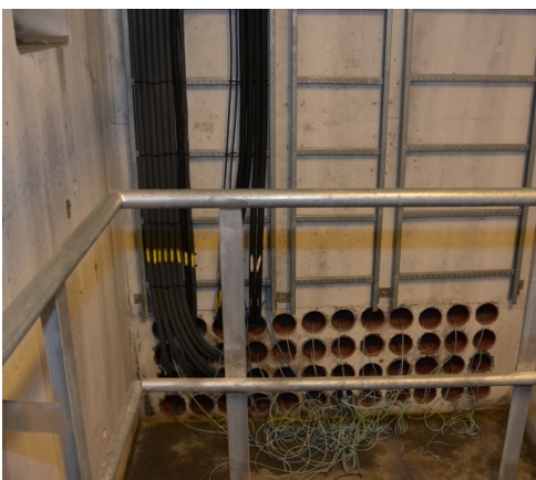
Trekkerør inn til hovedfordeling. Foto: Tore Paulsen
