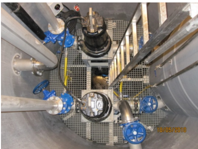
Pumpestasjon i kum. Foto: Terje Rønneberg
