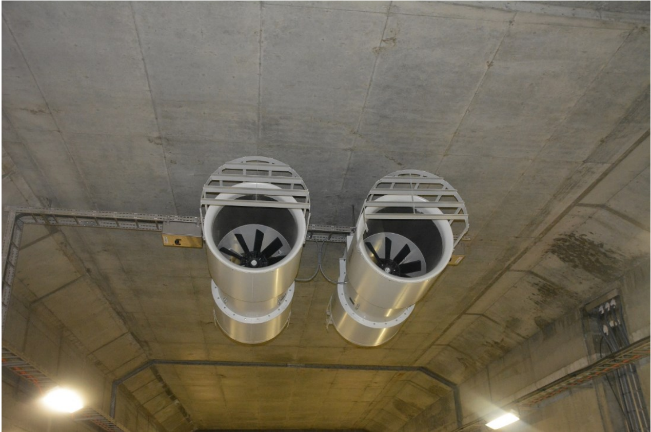
Figur 1 Ventilator (Foto: Tore Paulsen)
