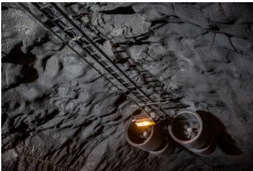
Figur 1 Ventilasjonsanlegg (Foto: Silje Drevdal, Statens vegvesen)
