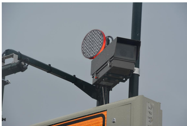
Luminansmåler utenfor tunnel. Foto: Tore Paulsen
