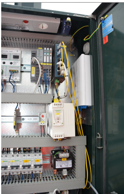
Måler plassert i fordelingskap. Foto: Tore Paulsen
