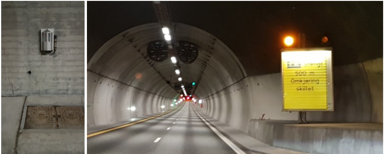
Figur 1 Evakueringsbelysning i form av punktlys på venstre vegg (Foto: Corinne Chiodini, Brennetunnel)
