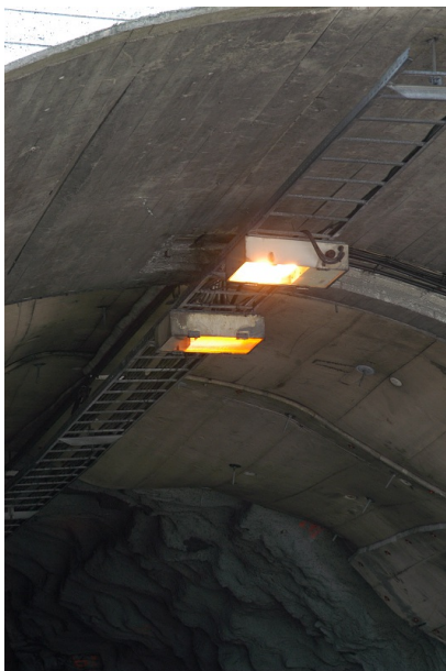
Lysarmaturer i Tunnel. Foto Kjell Wold
